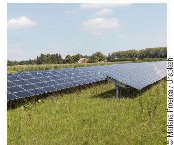
PV-Anlage im Freiland
