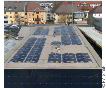
PV-Anlage auf dem Dach eines vermieteten Gebäudes
