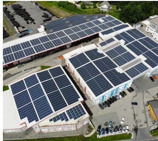
PV-Anlage auf dem Dach eines Betriebsgebäudes
