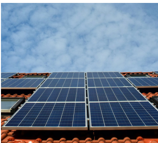
PV-Anlage auf gemieteten Dachflächen
