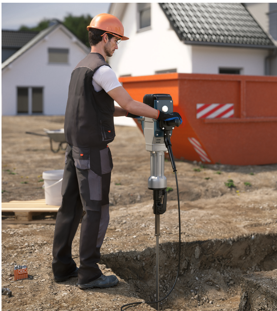
Eine der wichtigsten Anwendungen für Edelstahl findet sich dort, wo man ihn später kaum mehr sieht: bei Erdungsanlagen.
